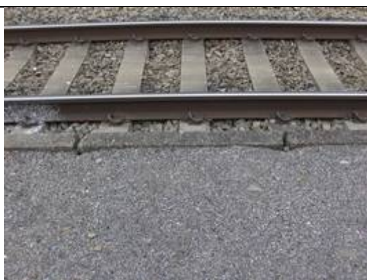
Absence de dalles podotactiles
