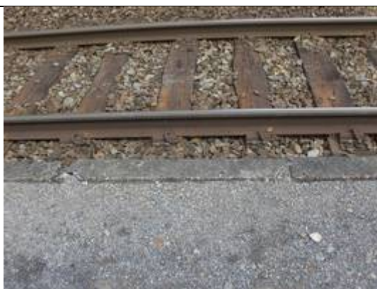
Absence de dalles podotactiles
