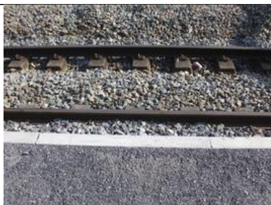
Absence de dalles podotactiles
