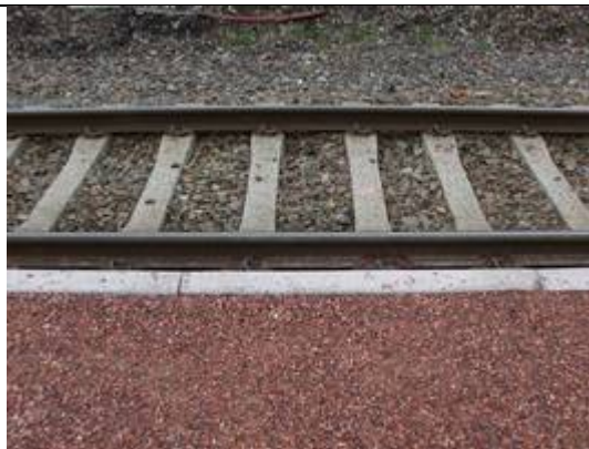
Absence de dalles podotactiles
