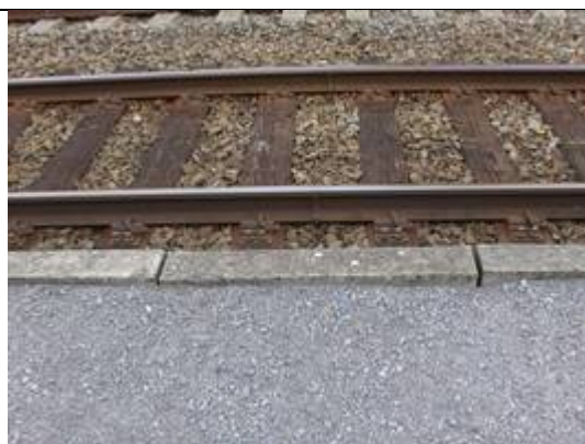
Absence de dalles podotactiles
