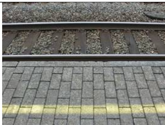
Absence de dalles podotactiles
