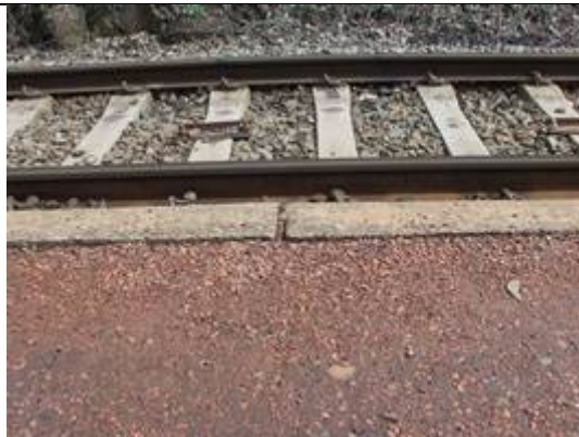
Absence de dalles podotactiles
