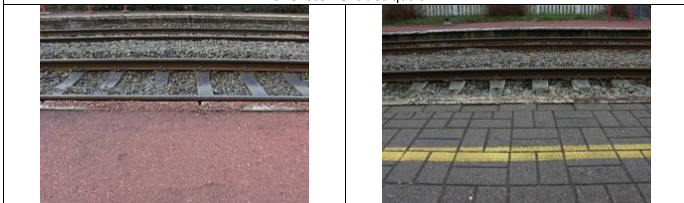
Absence de dalles podotactiles
